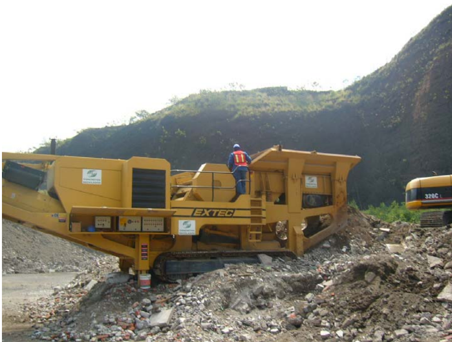
Figura 5.1 Equipo de Trituración Primario. Concretos Reciclados S.A. de C.V. 2006
