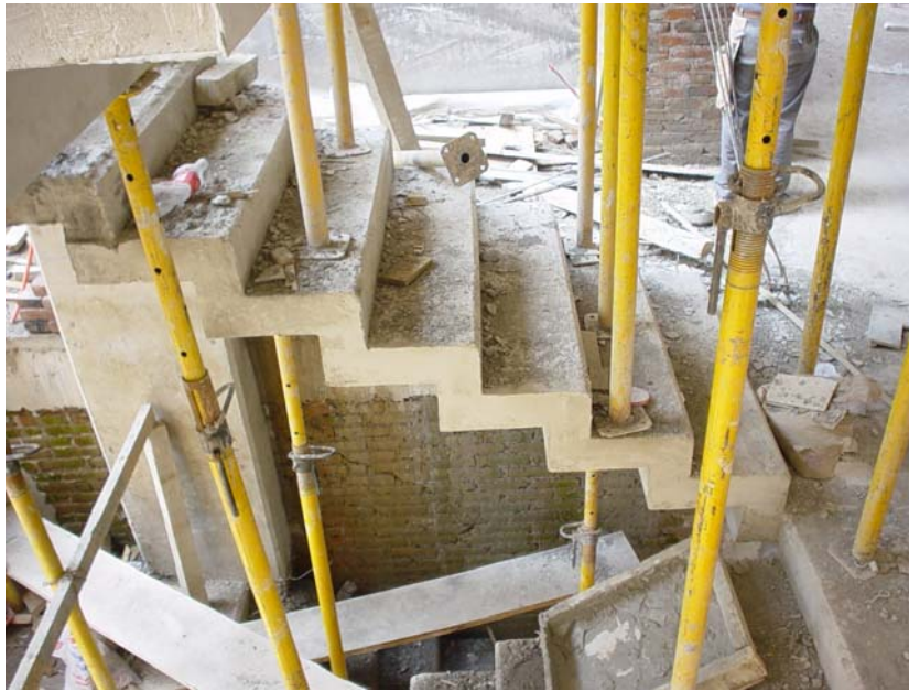
Foto 12. Escalera de emergencia.
