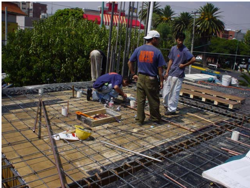
Fotografía 23. Cuadrilla de trabajadores sin casco.
