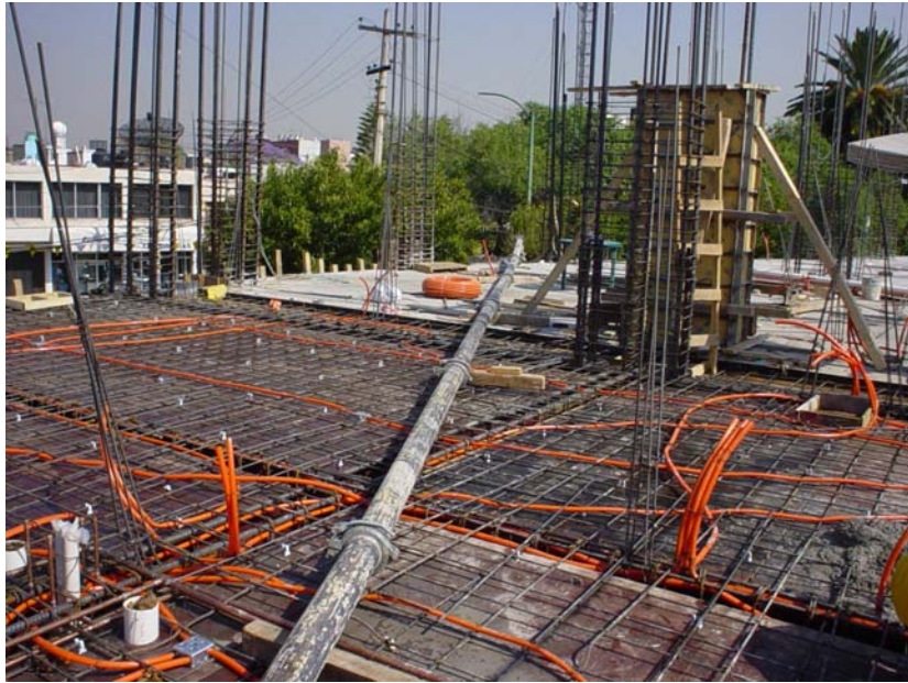
Foto 6. Manguera de la bomba estacionaria.
