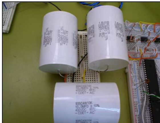
Figura 4.9 Filtro de Entrada
