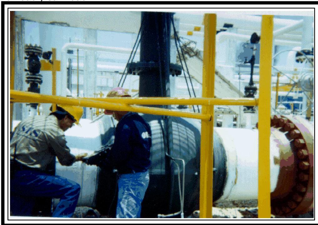
FIGURA No. 97 DETECCIÓN DE ANOMALÍA EN CARRETE DE 36" DIÁMETRO INSPECCIONADO CON EQUIPO EPOCH III
