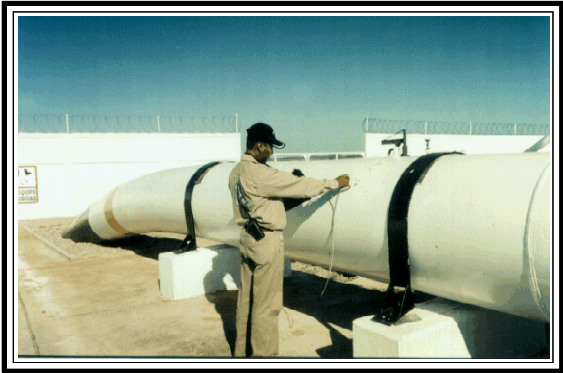
FIGURA No.98 INSPECCIÓN TIPO BARRIDO EN BAYONETA DE 36" DIÁMETRO LINEA No. 3 GAS AMARGO.
