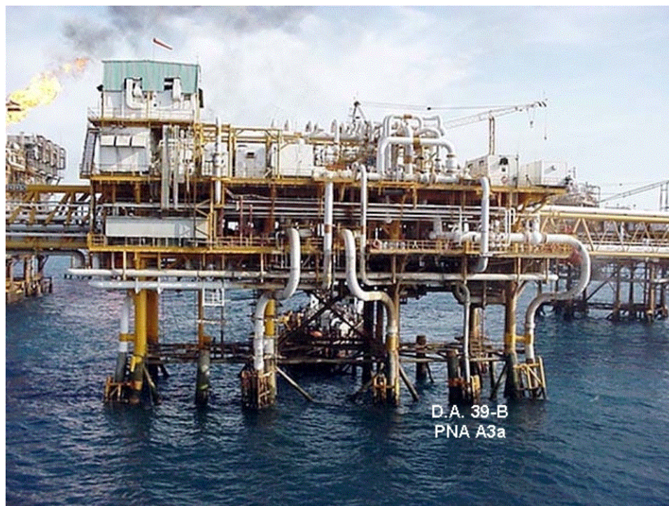
FIGURA No. 47 DUCTO ASCENDENTE EN PLATAFORMAS
