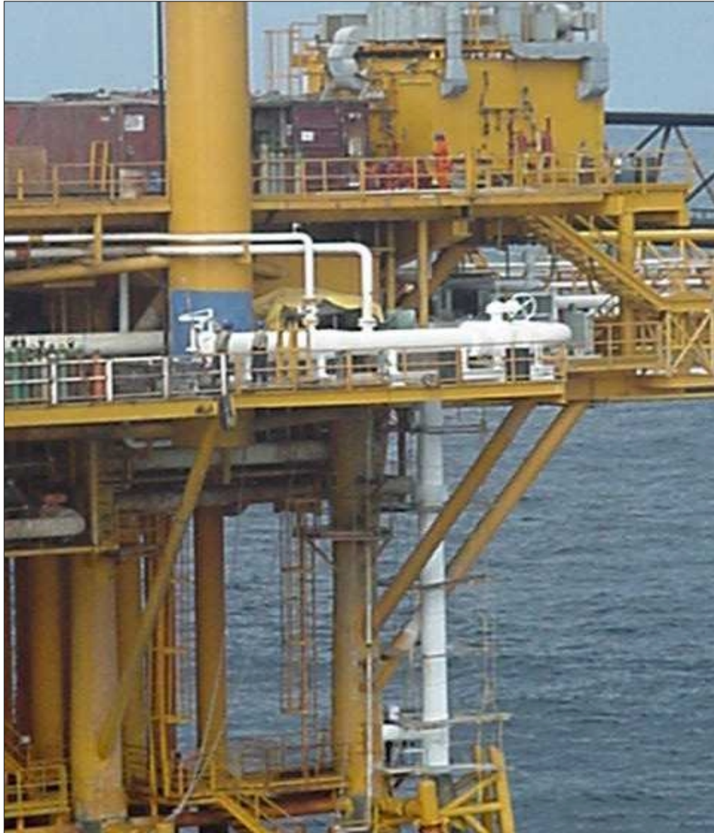
FIGURA No. 56 VISTA DE ANDAMIOS DE APOYO PARA PINTAR EN DUCTO ASCENDENTE
